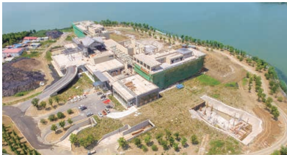
Four Seasons Hotel Suzhou is progressing well (site photo taken on 16 May 2018) 蘇州四季酒店工程進度理想 (2018年5月16日於項目實景拍攝)
