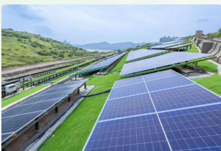
香港首個建於已修復的堆填區太陽能發電場
