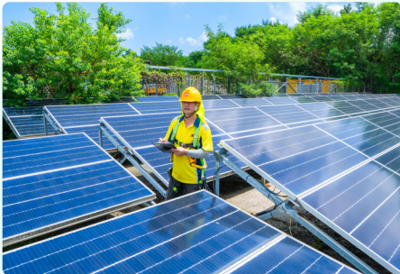
位於西沙建築工地的太陽能系統
