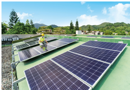
• 安裝在物業天台的太陽能光伏板
